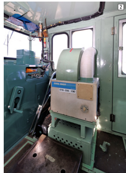
①台座にボルトで留められたR134aフロン(画面左)。誘導電動機(画面右)とはゴムベルトで結ばれる。②最終全般検査機EF65 2085号機の冷風装置本体もEMアンドケイプランニングが整備。全般検査には多くの企業と人が携わっている。
